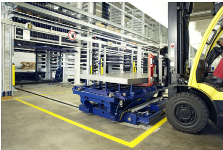
Der Gabelstapler setzt die Bleche auf die Ablagestempel der Einlagerstation. Danach werden die Bleche ins STOPA Lager eingelagert.
