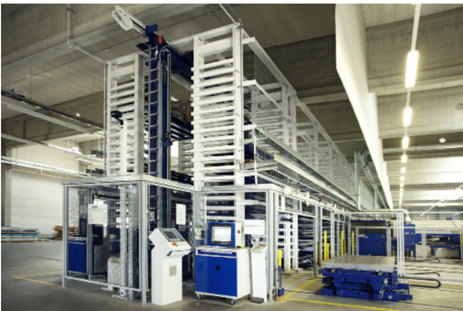
Das System ist rund 67,5 Meter lang und setzt sich aus 40 zweireihig angeordneten Regalblöcken zusammen, die, abzüglich der Stationen, Raum für 804 Lagerplätze bieten.
