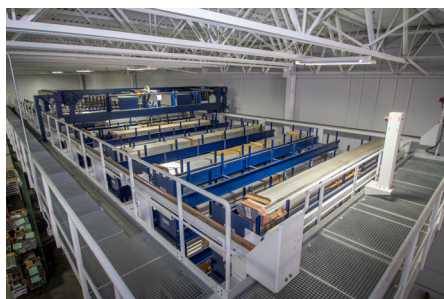
Ein überfahrendes Regalbediengerät lagert die Kassetten in den zwölf Gassen des Langgutlager ein und aus.
