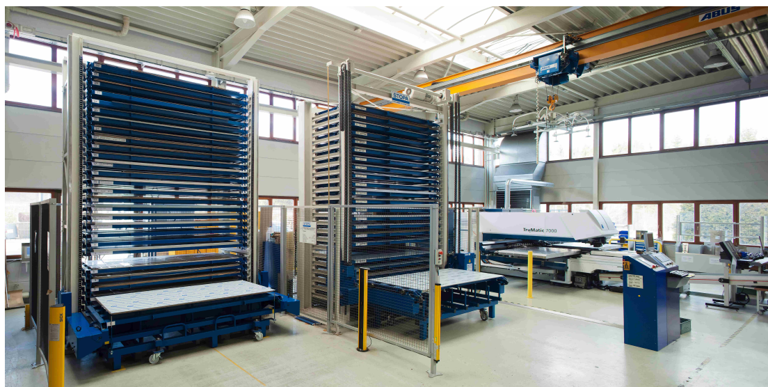
Die STOPA TOWER Blechlager beanspruchen wenig Platz und sind auf kurzen Wegen an die Laserschneid- und Stanzanlage von SCHAEFER angebunden
