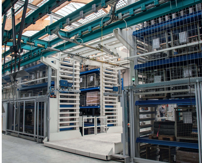
Die Produktions- und Montagehallen werden durch das Lager und über ein manuell betriebenes Hängebahnsystem verbunden
